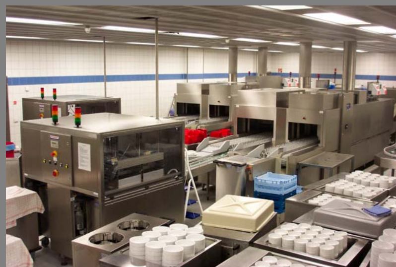
Zentralspüle mit Vollautomatikanlagen
